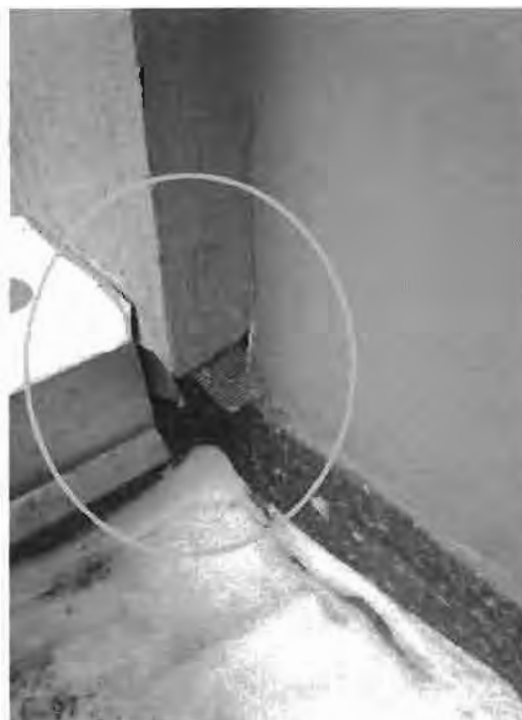
Фото 9. Фрагмент кровли козырька входной группы 4-го подъезда в осях Нс/5с-9с (по проекту шифр 07.001.74/14-04А-АР4, лист 4). Не заделано место примыкания парапетной стенки к наружной стене многоквартирного жилого дома. Стык стального фартука парапетной стенки козырька к наружной стене многоквартирного жилого дома не загерметизирован. Вертикальная трещина по отделке фасадов по осям Нс/9с.
