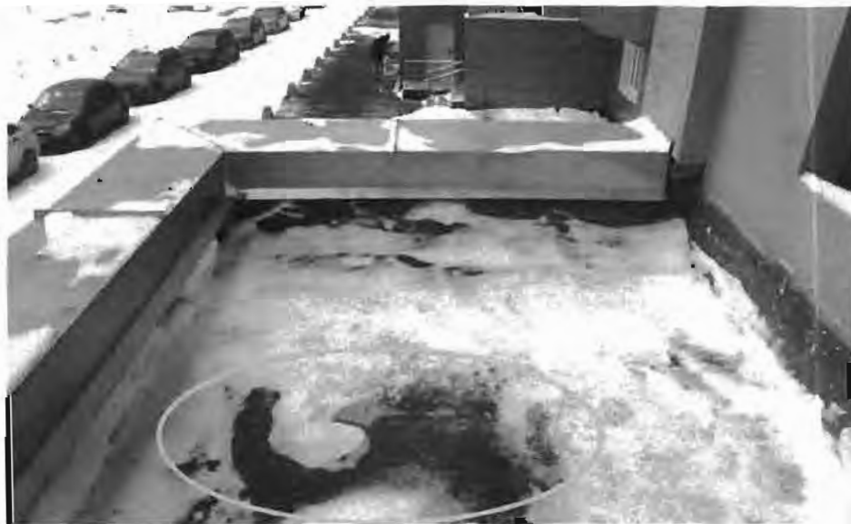
Фото 7. Фрагмент кровли козырька входной группы 4-го подъезда в осях Нс/5с-9с (по проекту шифр 07.001.74/14-04А-АР4, лист 4). Наледь по поверхности кровли козырька, уклон поверхности кровли недостаточен для удаления атмосферных осадков.
