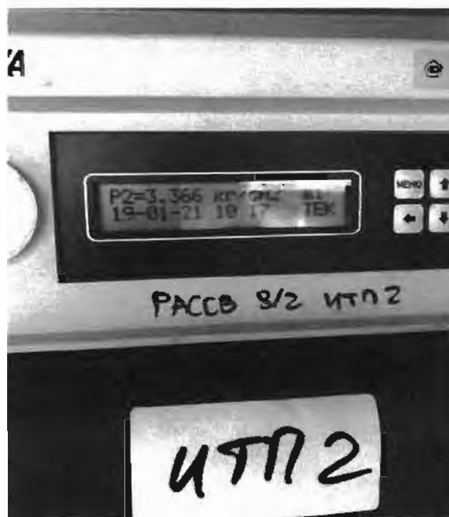
Фото 13. Давление на обратном трубопроводе в ИТП2 на момент проведения обследования 19.01.2021.
