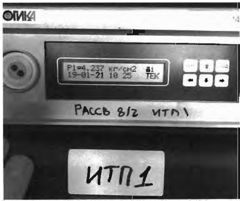
Фото 11. Давление на обратном трубопроводе в ИТП1 на момент проведения обследования 19.01.2021.
