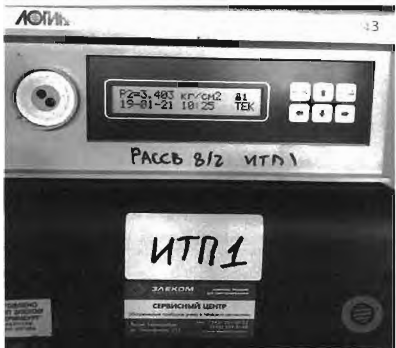
Фото 10. Давление на подающем трубопроводе в ИТП1 на момент проведения обследования 19.01.2021.
