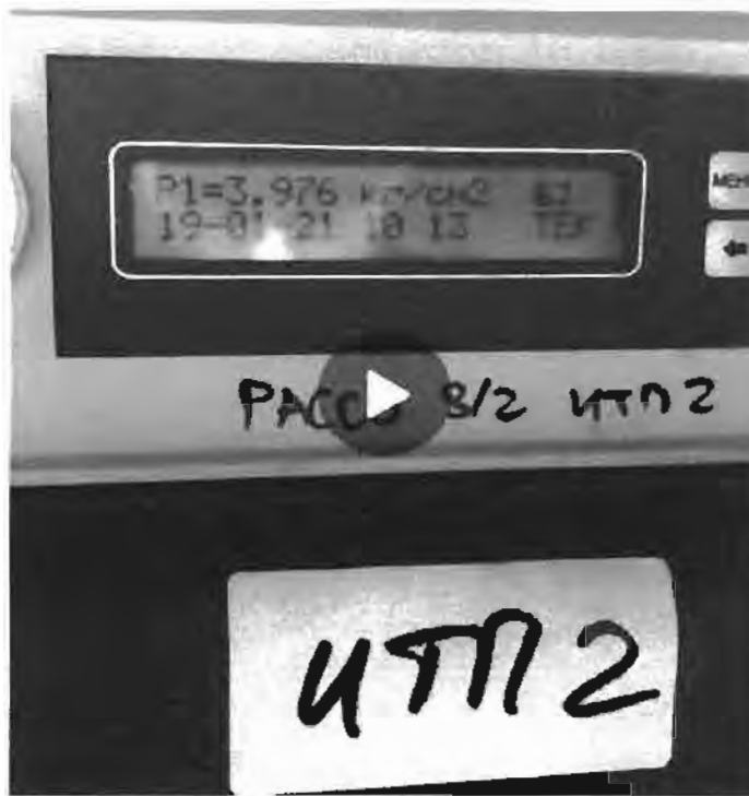
Фото 12. Давление на подающем трубопроводе в ИТП2 на момент проведения обследования 19.01.2021.
