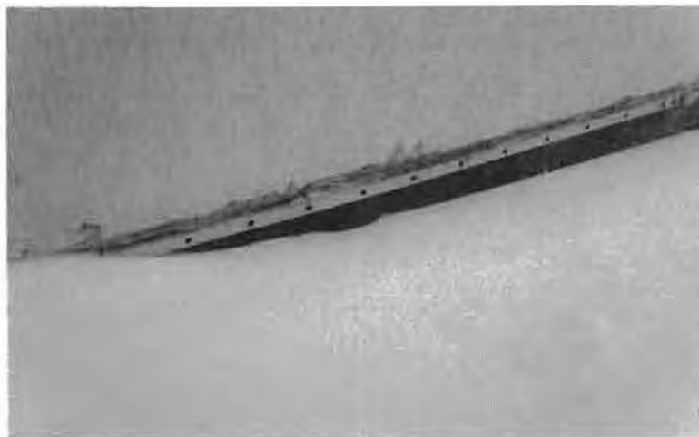
Фото 2. Фрагмент примыкания гидроизоляционного ковра к стенке в осях Гс/2с-3с (по проекту шифр 07.001.74/14-04Б-АРЗ, 3 секция, лист 5). Отслоение прижимного листа, разрушение герметика. Следы грязи и пыли на герметике и под прижимной металлической планкой. Трещины по поверхности герметика.
