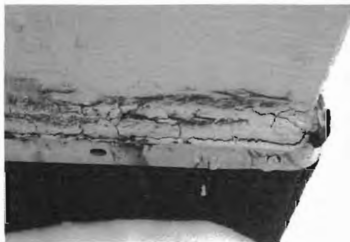
Фото 5. Фрагмент углового примыкания гидроизоляционного ковра к стенкам вентиляционной шахты в осях Жс-Кс/2с (по проекту шифр 07.001.74/14-04Б-АРЗ, 3 секция, лист 5). Следы грязи и пыли на герметике и под прижимной металлической планкой. Трещины по поверхности герметика. Следы ремонта и окраски отремонтированного фрагмента.
