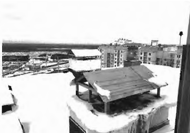
Фото 14. Вытяжные шахты естественной вентиляции с устройством выброса вытяжной зонг.
